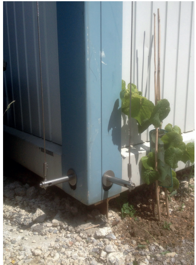
Montage sur container de bureau
