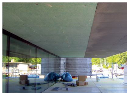
Décalage de plafond sous le logement
